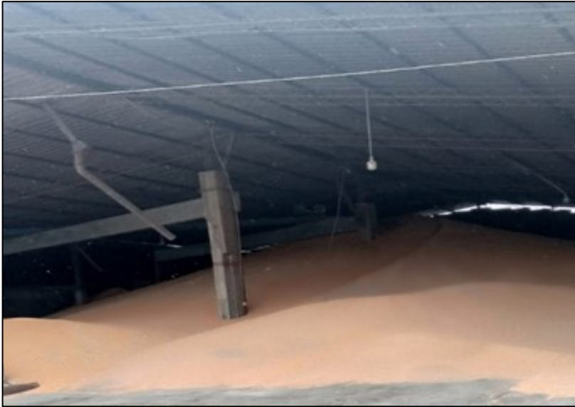
Figura 6. Zona de almacenamiento temporal
